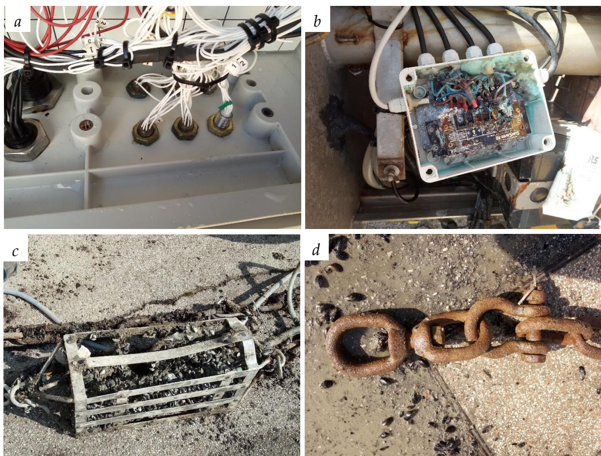
Figura 8. Particolari dei danni subiti dal sistema E1: elettronica di controllo allagata (a), elettronica gestione fotovoltaico allagata (b), secondo livello sensori ostruito (c), punto di rottura dell'ancoraggio (d)
